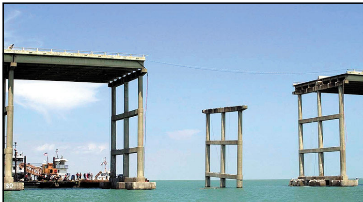
Queen Isabella Causeway, Port Isabel i South Padre Island, Texas, USA 4 natovarene maone udarile su u stup mosta uzrokujući djelomično rušenje rasponske konstrukcije mosta, 2001. 8 poginulih. Rušenje mosta imalo je ozbiljne ekonomske posljedice jer su preko mosta prelazila vodoopskrba i elektro napajanje otoka. Obnova je koštala 5 mil. $.
