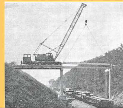
Prikaz postavljanja montažnih nosača s pomoću dizalice koja se kreće po mostu. Rasponi mosta oko 13 m
